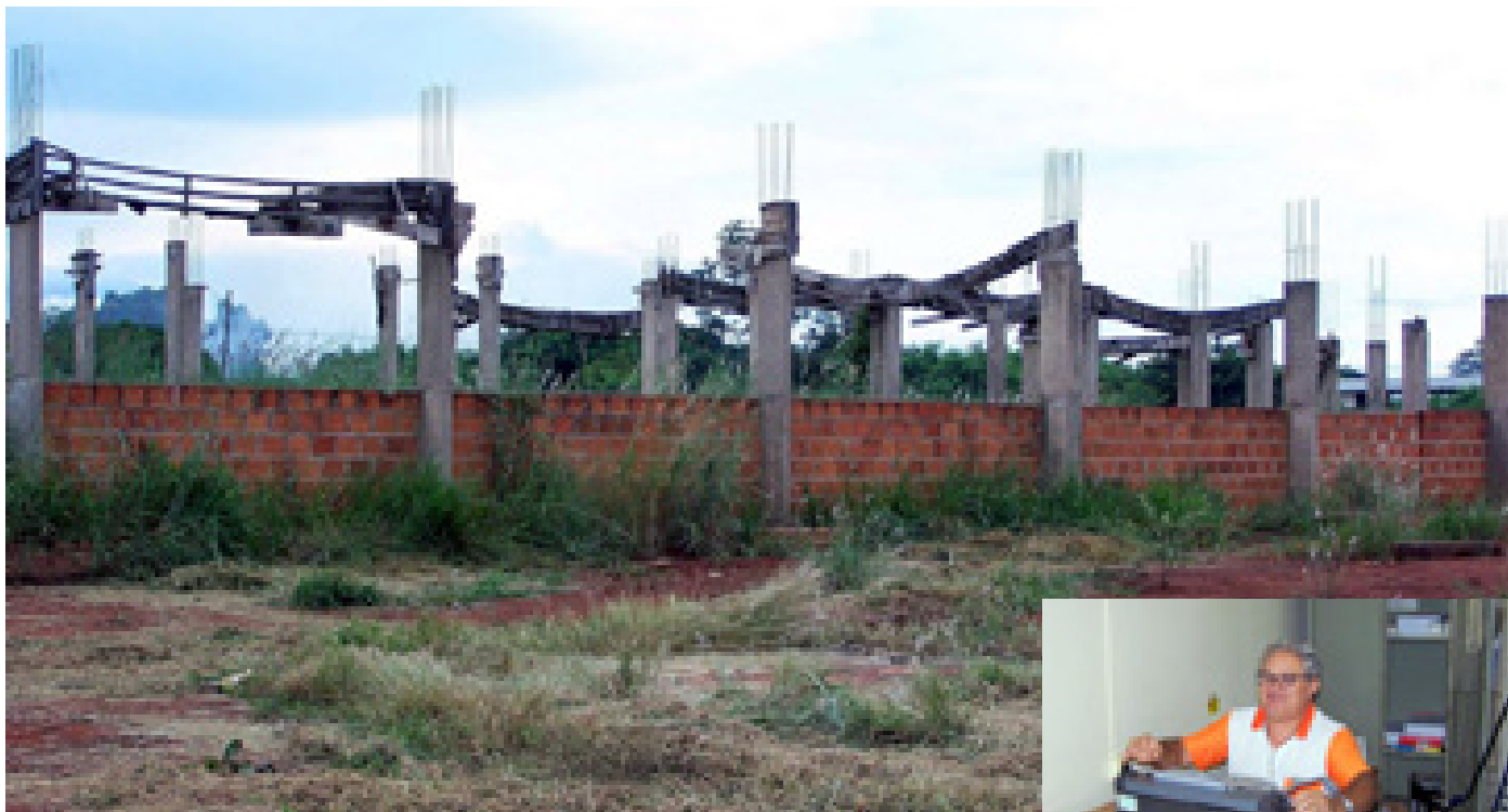
Obra inacabada do NRPTC de Itumbiara
